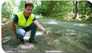
Blötanvägen i behov av underhåll, gatuchef Ola Karlsson. Foto Bernd Blankenburg, SMP
