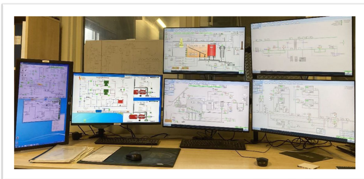
Övervakning av fjärrvärmesätet hos dotterbolaget Tingsryds Energi AB.
